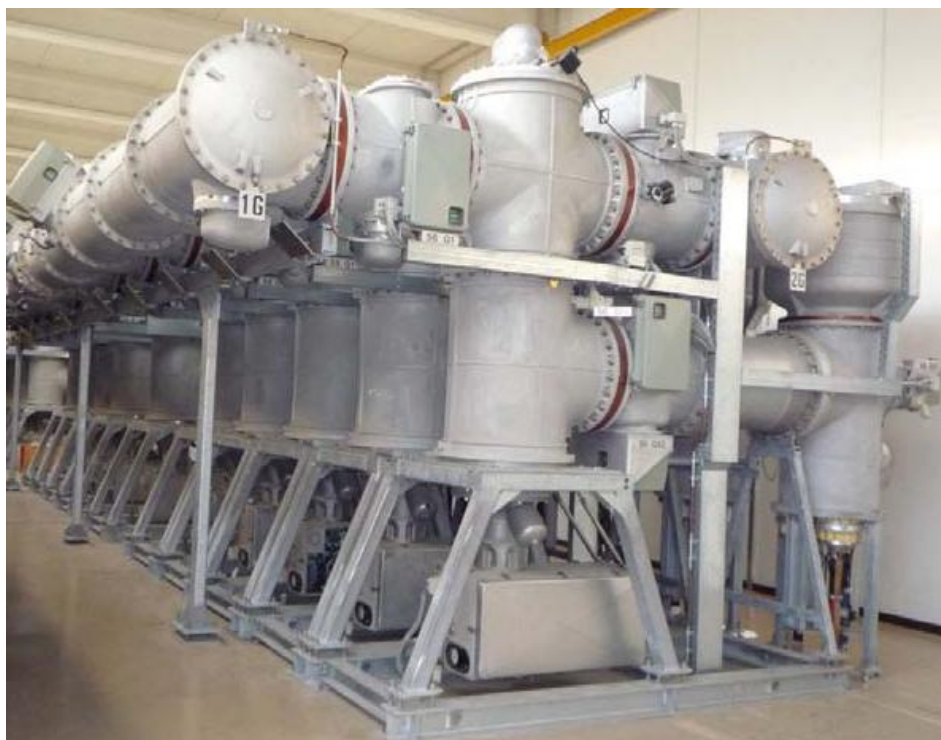
Equipements HT du poste de Galicien avec isolation SF 6 de type ELK de ABB
