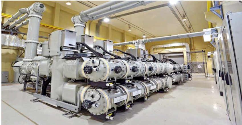
Exemple de matériel récent avec isolation \text{SF}_6 tel que prévu pour le poste de Romanel.
