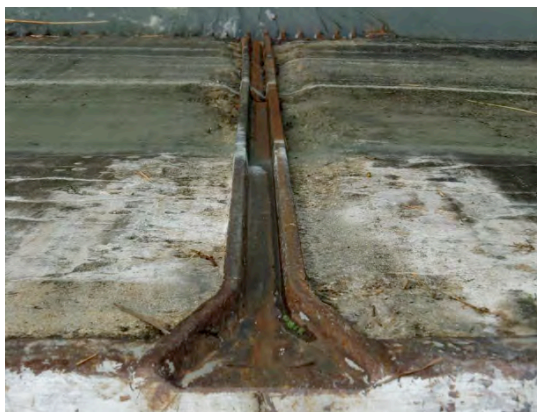
Etat d'une glissière et des bétons en avril 2015
