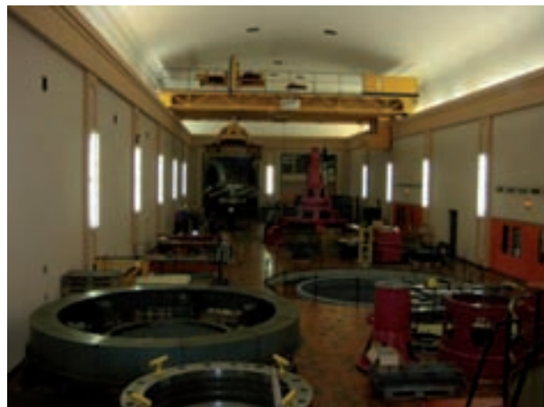
Vue de la salle des alternateurs avec les éléments principaux du groupe 2 démontés
