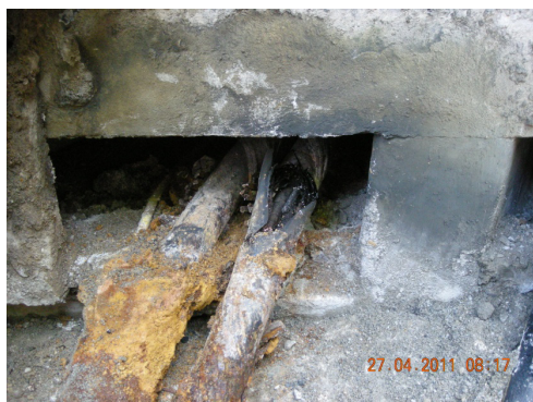
Avarie sur un câble à moyenne tension due au vieillissement (zone Borde-Villette)
