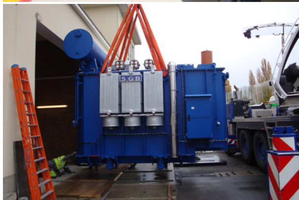
Poste « Expo » : installation d'un nouveau module GIS (gas insulated switchgear) 50 kV et du nouveau transformateur de 25 MVA
