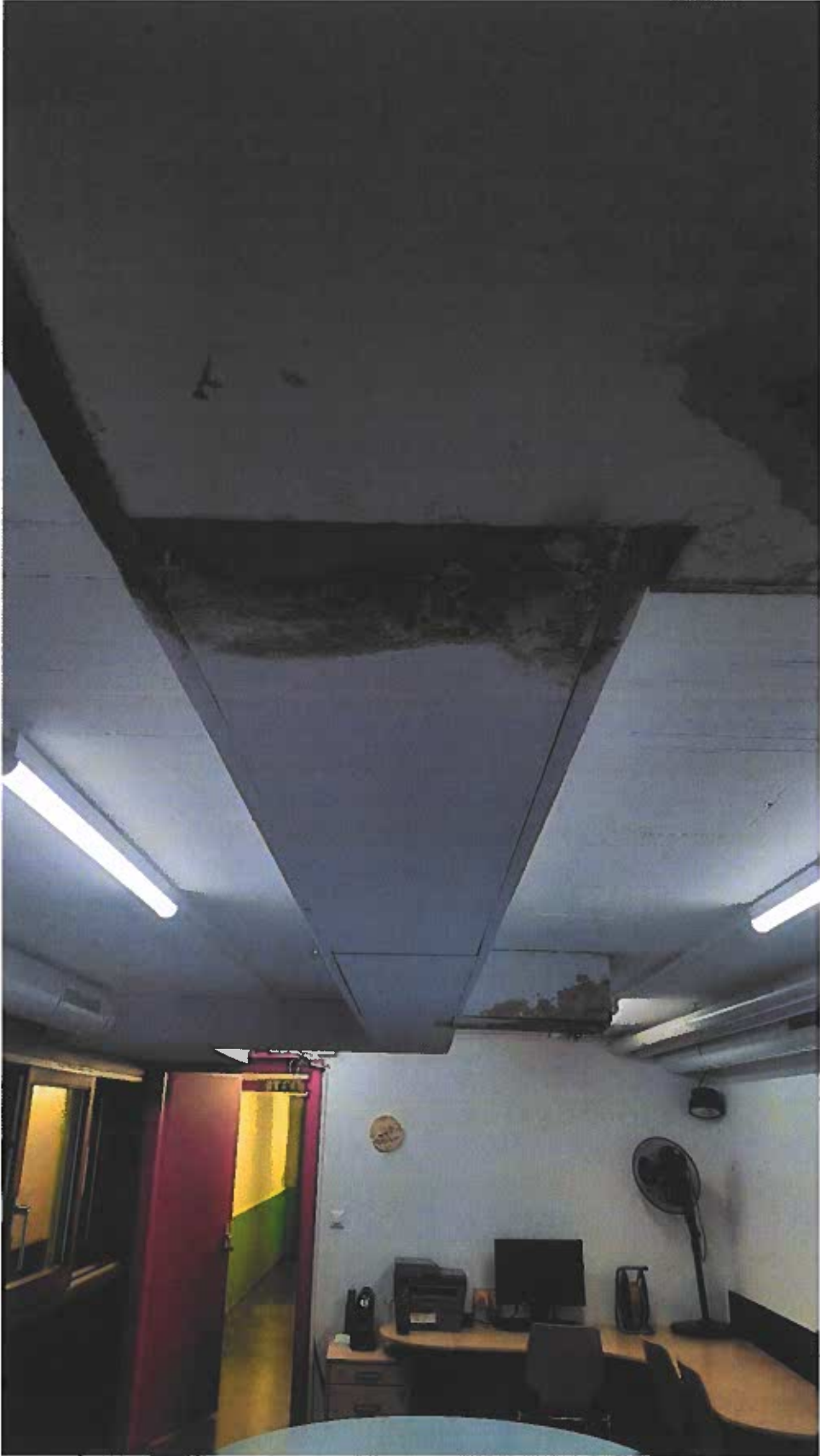
Annexes : photos de la détérioration des conduites d'eau et de la salle, prises entre 2023 et 2024
